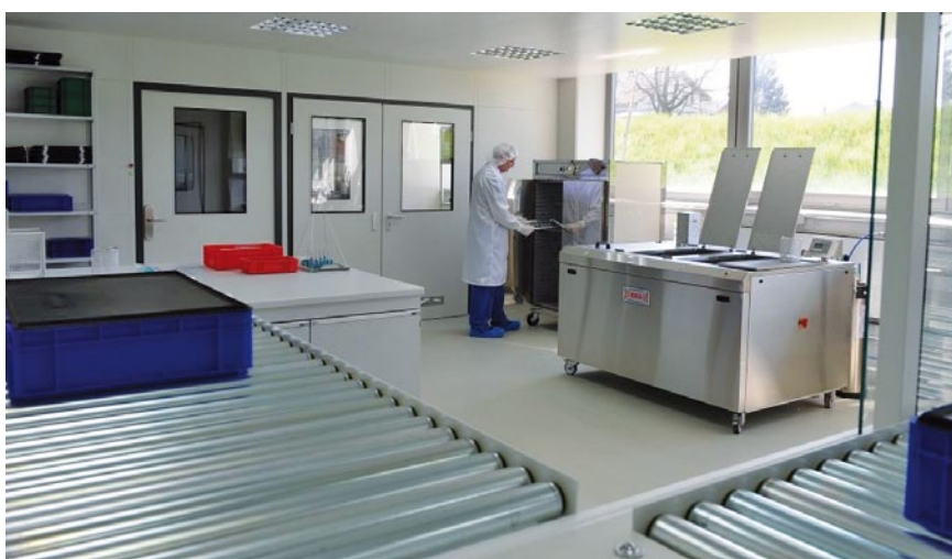
Die Reinraumanlage ist in verschiedene Sektionen unterteilt, um dort nicht nur die Beschichtung, sondern auch alle vor- und nachgelagerten Arbeitsschritte, wie Teilereinigung oder Maskieren und Prüfen, durchführen zu können. Sie bildet damit eine autarke Produktionseinheit.
